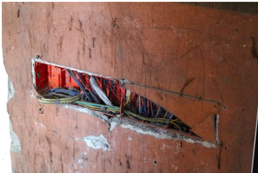
Fili della luce scoperti sul muro di un palazzo
